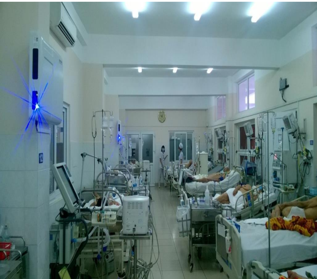
Lắp đặt 02 Airocide GCS-50 tại phòng hồi sức lớn, Khoa HSTC&CD
