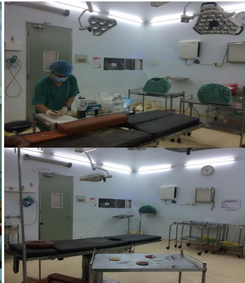
Lắp đặt Airocide GCS-50 (01máy/phòng) tại Phòng mổ, Khoa GMHS
